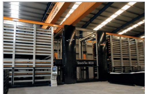
Automatic Storage Almacén automático
